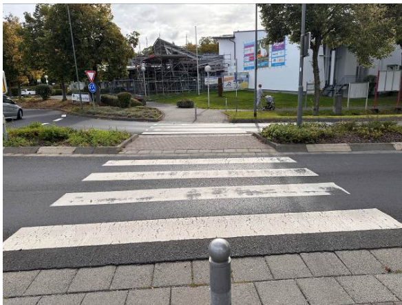
Querung im Bereich ZAP/Rhein-Mosel-Straße ohne taktilen Leitsystem
